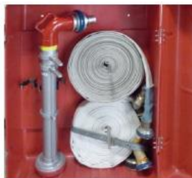
スタンドパイプとホース
