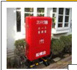
↑スタンドパイプ
