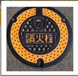
↑消火栓マンホール (黄色で囲っているのが目印)
