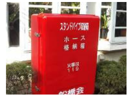
町会設置スタンドパイプ
